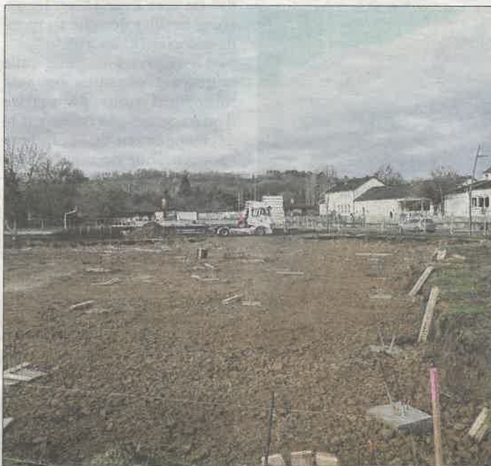
Un camion vient livrer le fer attendu... mais rien ne sort encore de terre, six mois après les premiers coups de pelle du chantier du périscolaire à Kédange-sur-Canner. Photo RL
